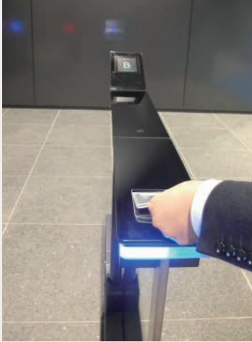
ゲートで乗るべきエレベーターを表示
